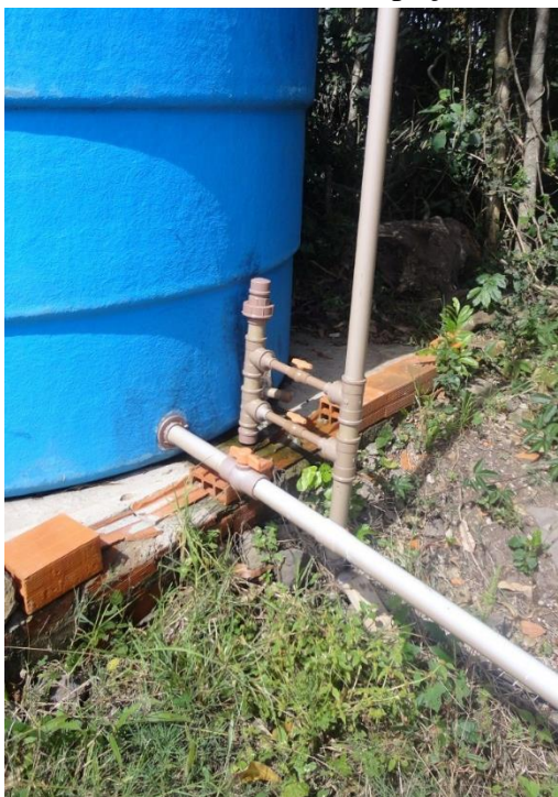
Figura 67 - Clorador utilizado nos poços da área rural.
