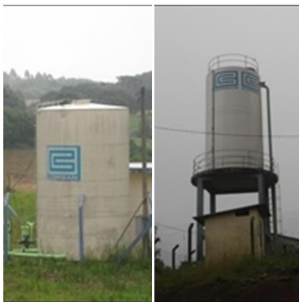
Figura 70 - Localização do poço artesiano e o reservatório
